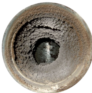
Ventilasjonskanal før rens
